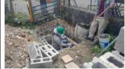
FOTO 60. Caja de telecomunicaciones sector Flam
