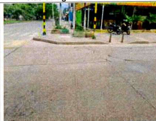
Foto 5. Vías con grietas transversales
