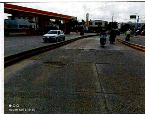
Foto 8. Vías urbanas en mal estado
