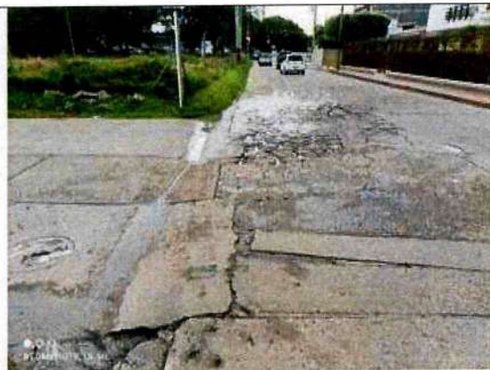
Foto 6. Vías con grietas transversales
