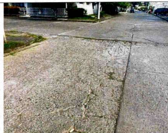
Foto 7. Vías urbanas en mal estado
