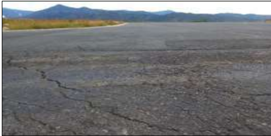
Fotografía No.: 2 Plataforma, pavimento con grietas longitudinales, agregado expuesto.
