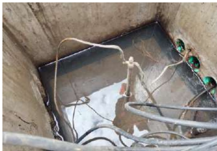
Figura 22 Estado de las cajas de inspección
