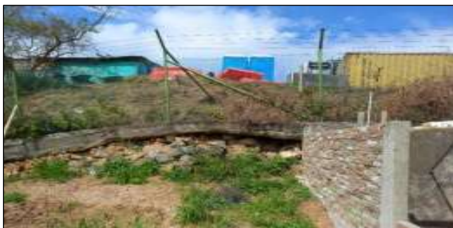
Fotografía No.: 5 Cerramiento perimetral en mal estado, construir muro para estabilizar el sector oriental.
