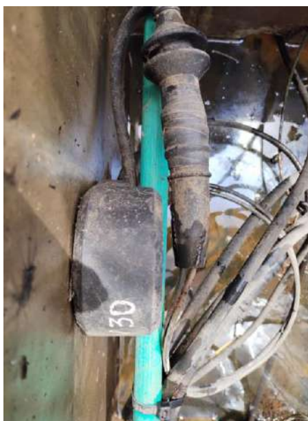
Figura 26 Estado del encintado en los conectores secundarios
