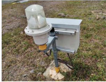
Figura 17 Estado de sistema REIL
