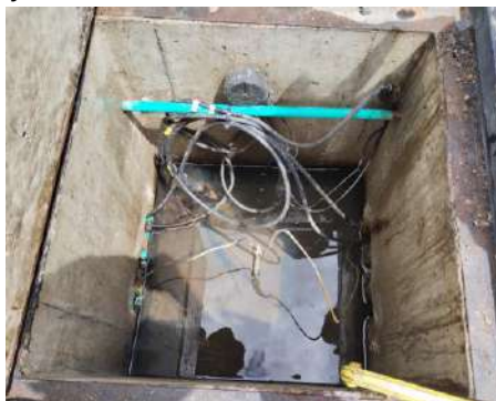
Figura 10 Ausencia de conexión de las balizas al sistema de puesta a tierra
