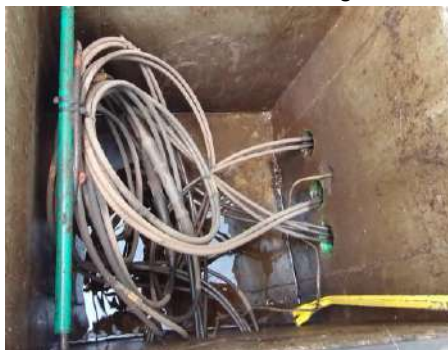
Figura 21 Estado de las cajas de inspección
