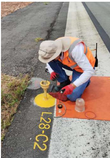
Figura 1 Correctivo baliza L28-C2 Fuente: Propia
