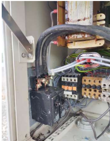
Figura 19 Estado de sistema REIL
