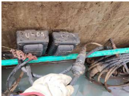
Figura 25 Estado del aislamiento de los cables secundarios
