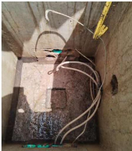
Figura 3 Estado del anillo de puesta a tierra Fuente: Propia
