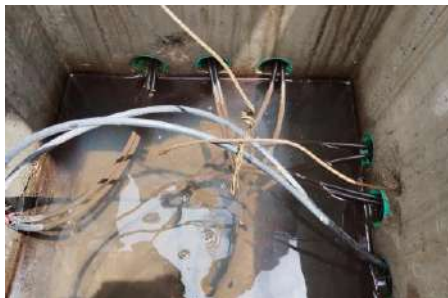
Figura 7 Estado del anillo de puesta a tierra
