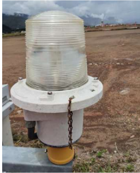
Figura 15 Estado de sistema REIL Fuente: Propia
