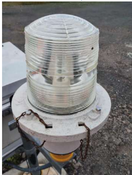
Figura 16 Estado de sistema REIL Fuente: Propia
