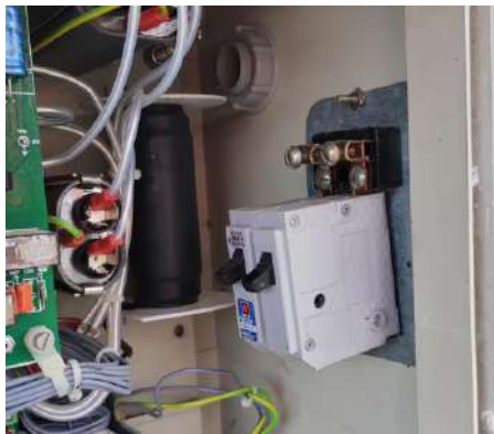
Figura 20 Estado de sistema REIL
