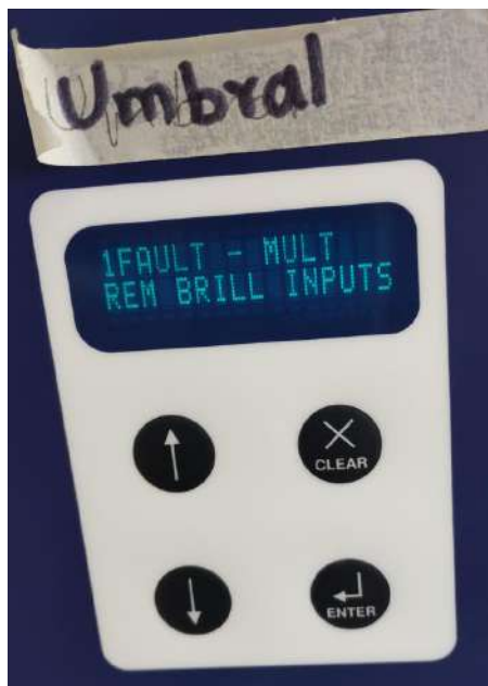
Figura 29 Mensaje de falla en remoto del CCR
