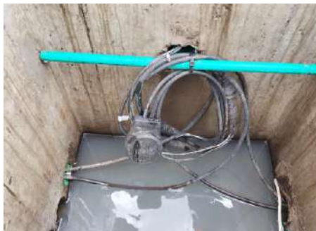
Figura 11 Ausencia de conexión de las balizas al sistema de puesta a tierra Fuente: Propia
