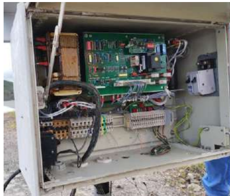
Figura 18 Estado de sistema REIL
