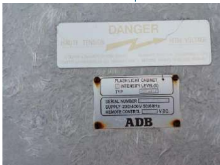
Figura 14 Estado de sistema REIL Fuente: Propia
