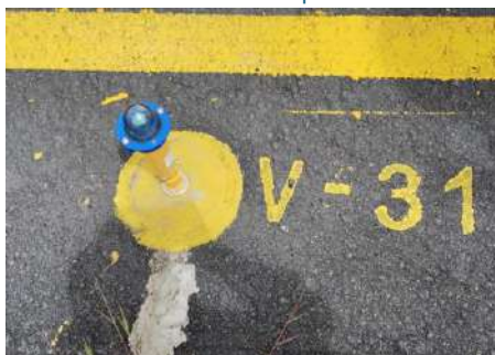
Figura 12 Ausencia de conexión de las balizas al sistema de puesta a tierra Fuente: Propia
