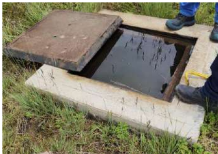
Figura 28 Nivel de agua en la caja de inspección
