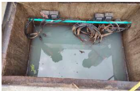
Figura 2 Nivel de agua en la caja de inspección cubriendo el electrodo Fuente: Propia
