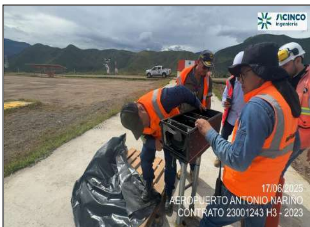
Fot. No. 4 - Revisión del estado y entrega a la entidad del modulo No. 2 de las luces PAPI umbral 2-0 del aeropuerto, después del daño ocasionado por el consorcio ALFA.
