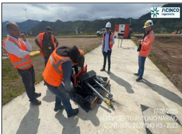
Fot. No. 3 - Revisión del estado y entrega a la entidad del modulo No. 2 de las luces PAPI umbral 2-0 del aeropuerto, después del daño ocasionado por el consorcio ALFA.
