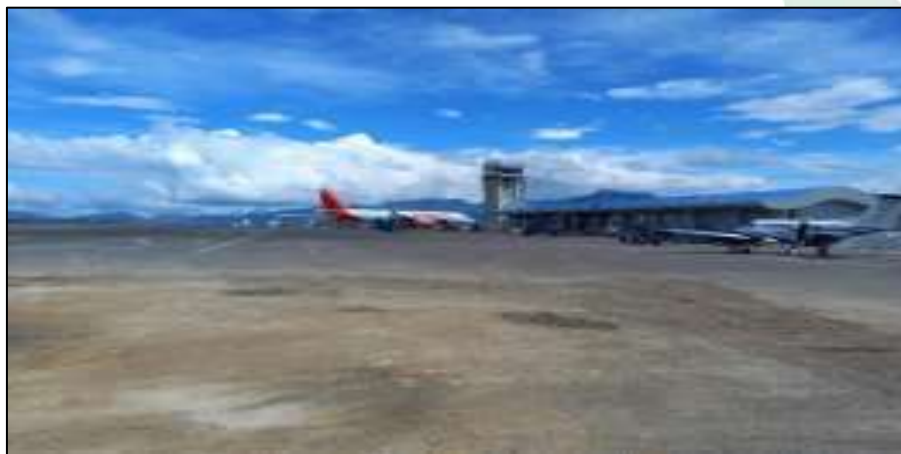
Fotografía No.: 3 Plataforma, pavimento sector con deformaciones y piel de cocodrilo.
