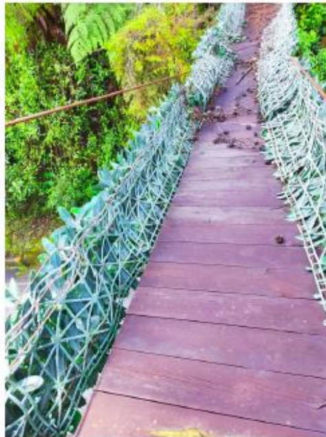
Foto 9. Paso de fauna arborícola tipo cajón
