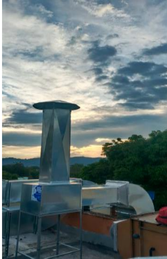
Sistema de extracción instalado
