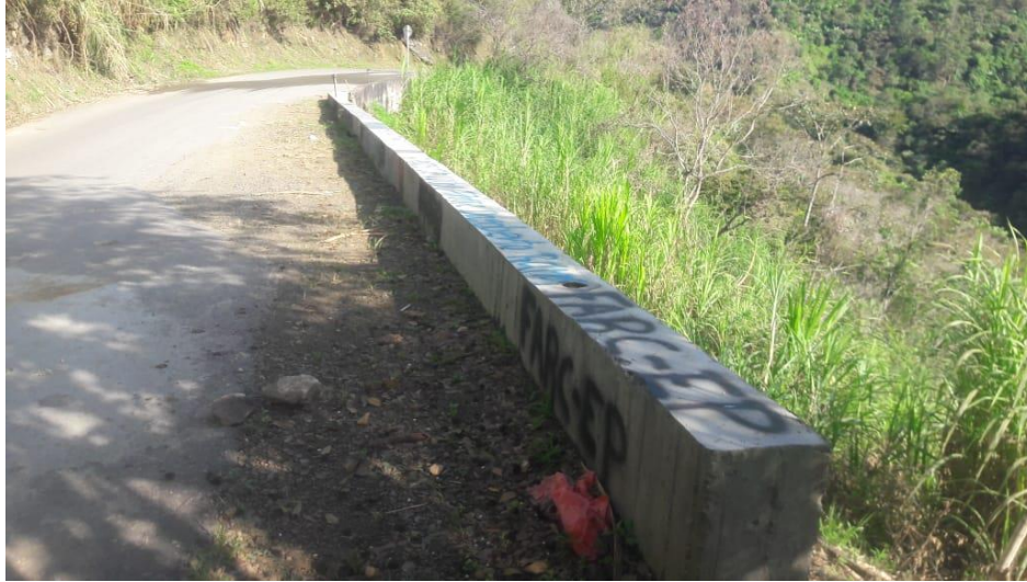
PR 123+219 Muro de Contención (Falta Anclajes)
