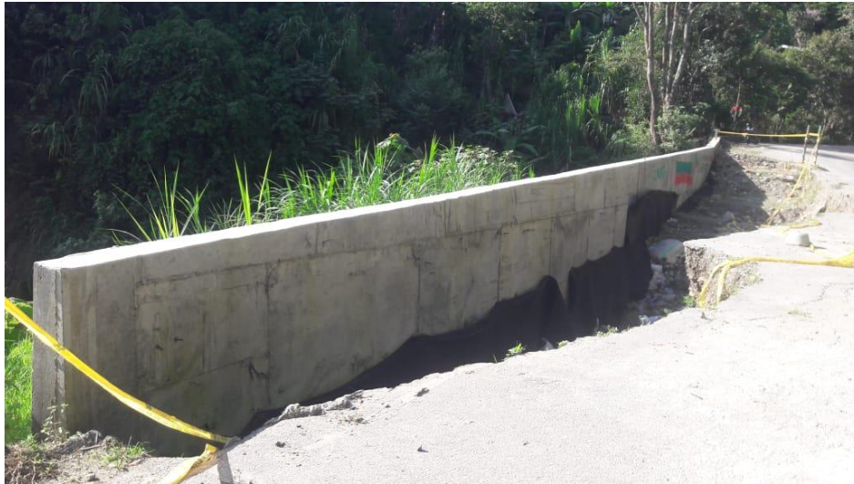
PR 122+970 Muro de Contención (Falta Relleno y Anclajes)
