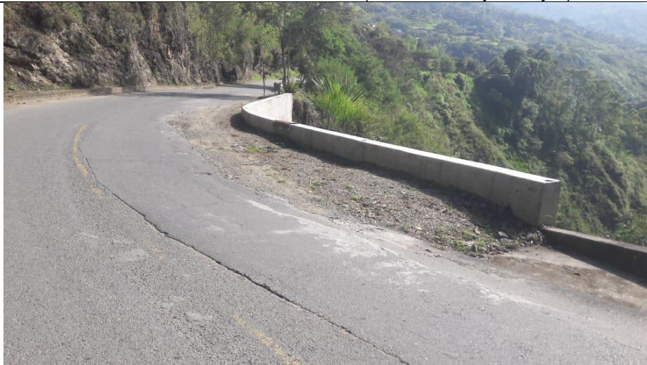
PR 122+075 Muro de Contención (Falta Anclajes)
