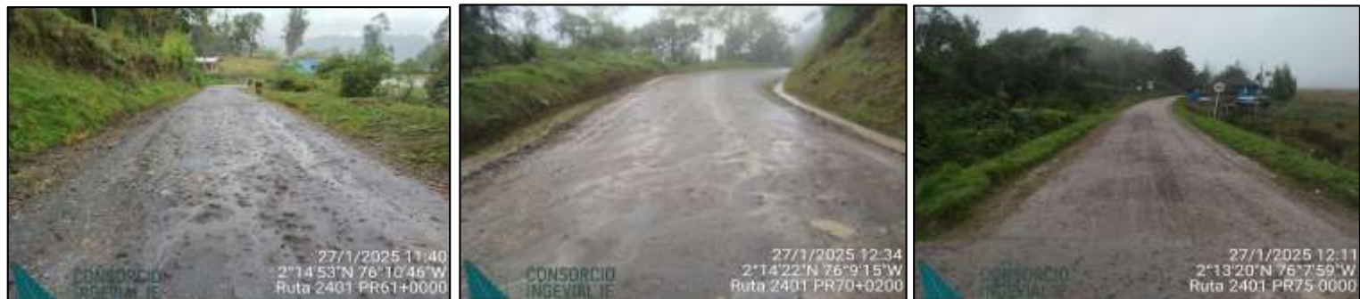
PR61+0000, PR70+0200, PR75+0000 Sectores en afirmado con daños tipo baches, surcos y cabezas duras.
