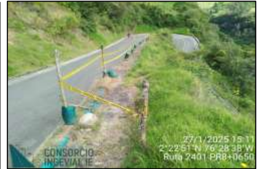
PR08+0650 Punto crítico, talud inferior inestable
