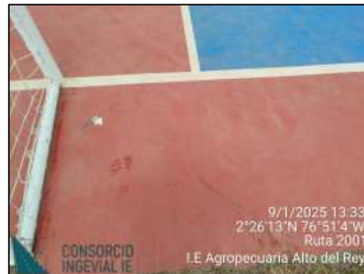
Desprendimiento puntual de capa superficial y/o pintura.
