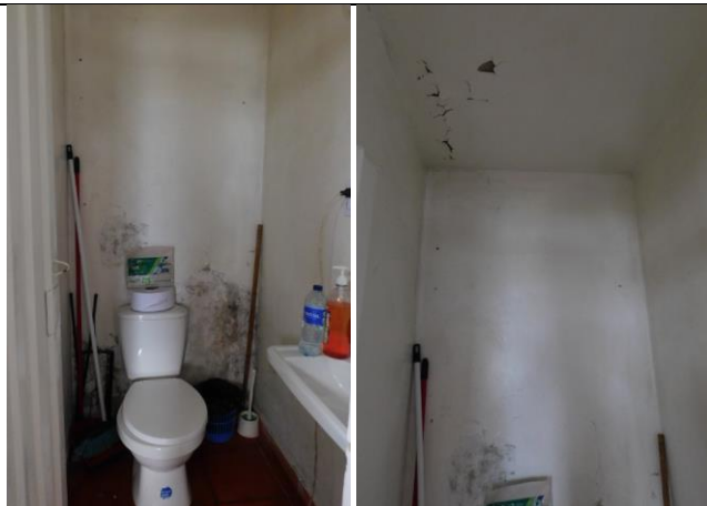
ESTADO ACTUAL DE BAÑO OFICINA DE SANIDAD
