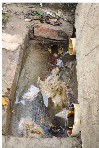
CAJA ACTUAL DE AGUAS LLUVIAS
