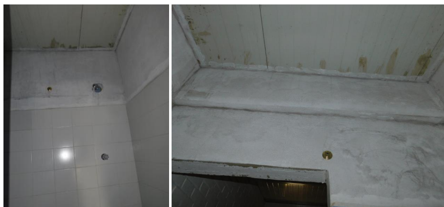
ESTADO ACTUAL DE BAÑO DORMITORIOS, NO TIENE SUMISTRO HIDRÁULICO
