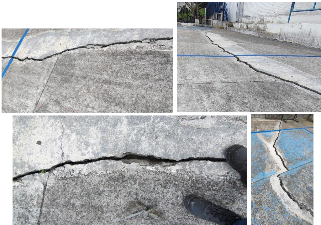
ESTADO ACTUAL DE CANCHA
