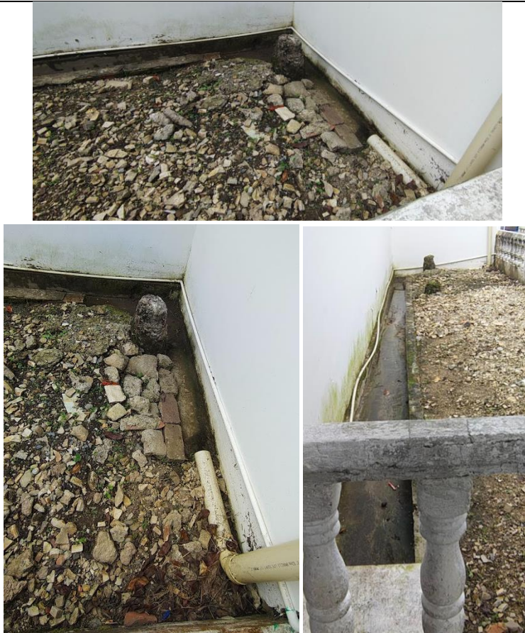
ESTADO ACTUAL DE CANAL DE AGUAS LLUVIAS DE PISO
