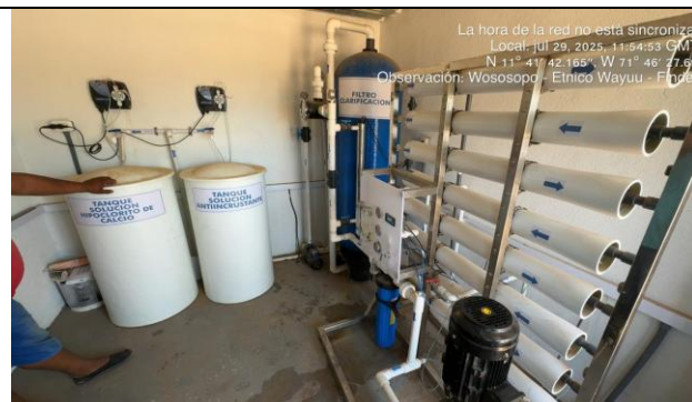
Fotografía 6. Sistema de potabilización de agua por medio de osmosis inversas en la comunidad de Wososopo.
