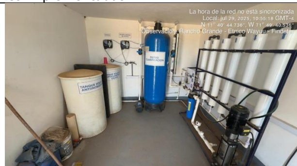
Fotografía 2. Sistema de potabilización de agua por medio de osmosis inversas en la comunidad de Rancho Grande.
