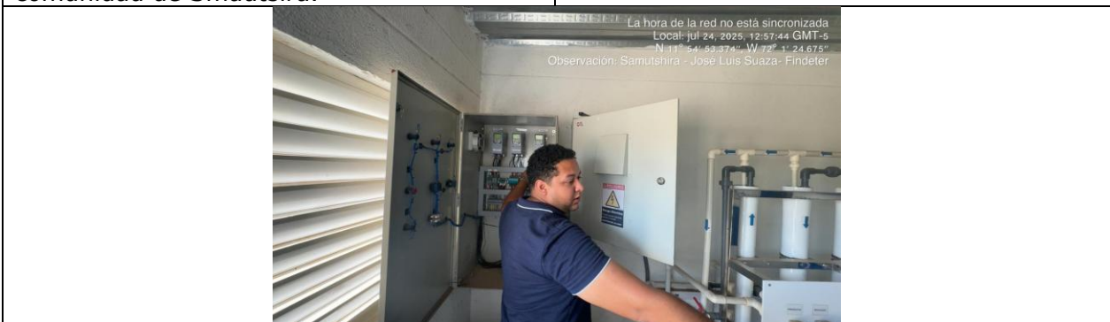
Fotografía 7. Revisión de sistema eléctrico en la comunidad de Samutsira.
