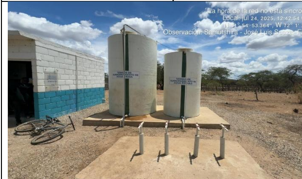
Fotografía 5. Sistema de potabilización de agua por medio de osmosis inversas en la comunidad de Smautsira.
