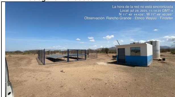
Fotografía 1. Sistema de potabilización de agua por medio de osmosis inversas en la comunidad de Rancho Grande.
