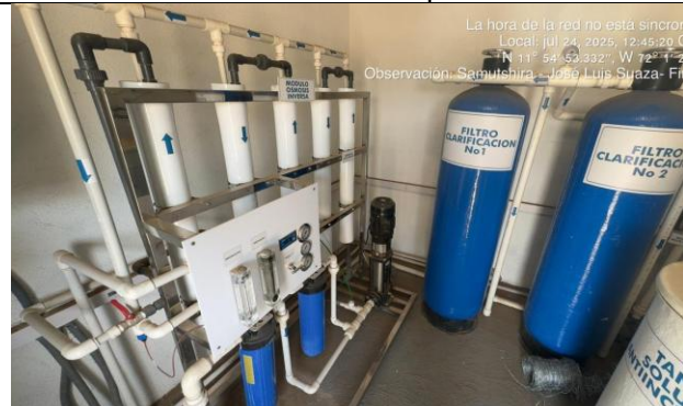
Fotografía 6. Componentes del sistema en buenas condiciones, insumos químicos.
