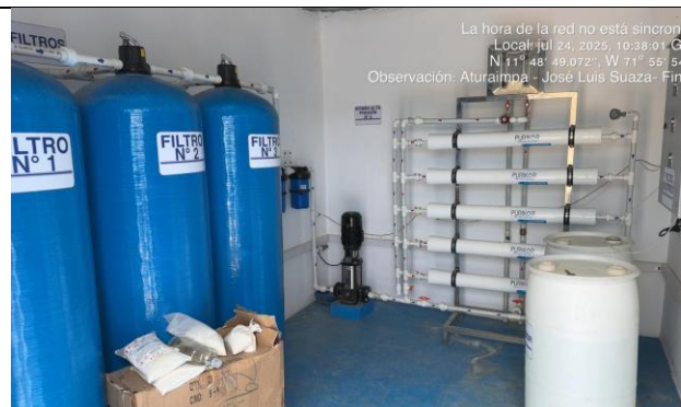
Fotografía 2. Componentes del sistema en buenas condiciones, insumos químicos.
