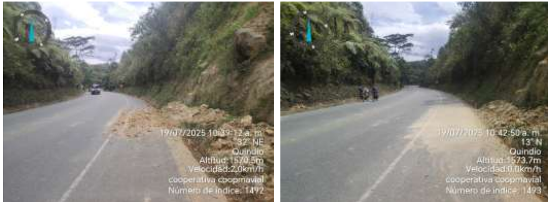
Imagen 1 y 2 Ruta 40QN05 PR 3+0050 Caída de material y despeje de la vía
