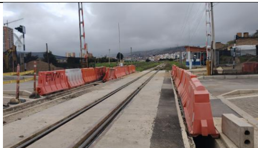
Cerramiento con maletines Cruce ferreo
