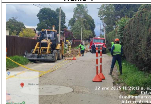
FOTO 41. Incidente de gas
