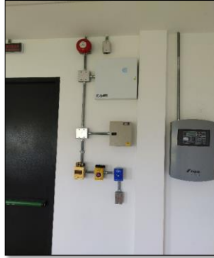
Imágen 11. Sistema de Agente Limpio Cuarto de Reguladores
