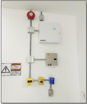
Imágen 10. Sistema de Agente Limpio Banco de Baterías
