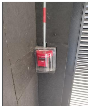
Imagen 5. Estación Manual Direccional en cuarto de Subestación Eléctrica
