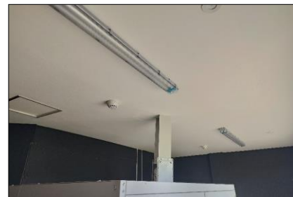
Imagen 6. Detector de humo en Cuarto de Subestación Eléctrica.
