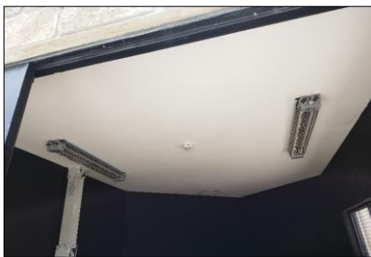
Imagen 4. Detector de humo en Cuarto de Planta Eléctrica.
