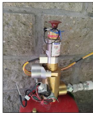
Imagen 8. Alarma manual del cilindro de Agente Limpio desactivada
