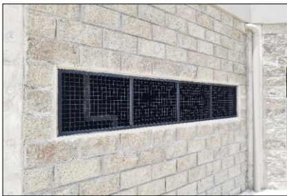
Imagen 1. Rejilla de ventilación Cuarto de Planta Eléctrica.
