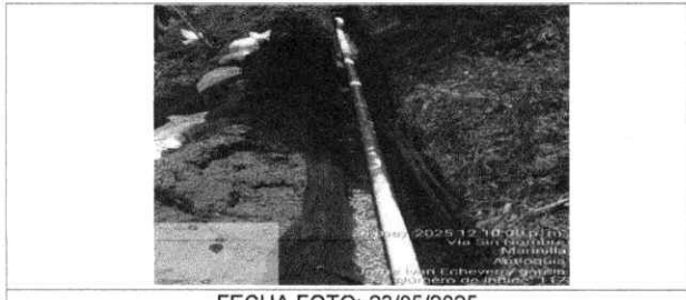
FECHA FOTO: 23/05/2025 DESCRIPCION: FILTRO.
