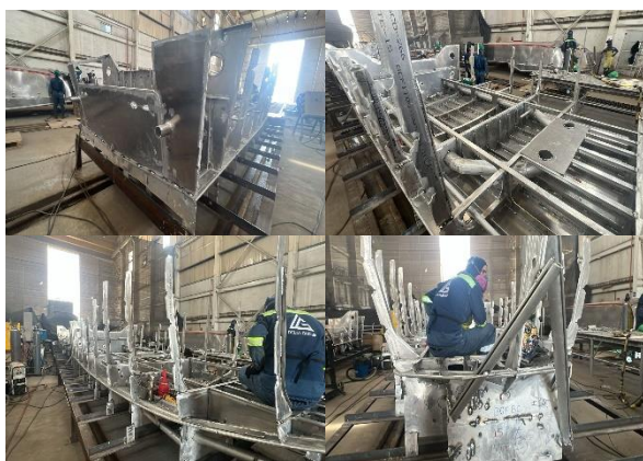
Foto No 137 a 140 –Bote 15 REFUERZOS, ESPEJO, CUADERNAS, Y TUBERÍA
