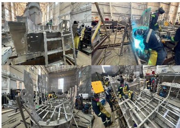
Foto No. 31 a 34 – Bote No. 10 Espejo, refuerzos y tuberías
