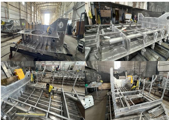
Foto No. 97 a 100 – Bote No. 13 REFUERZOS, CUADERNAS, BULÁRCAMAS Y TUBERÍA DE MANDO Y CONTROL
