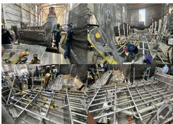
Foto No. 27 a 30 – Bote No. 9 Espejo, refuerzos y tuberías
