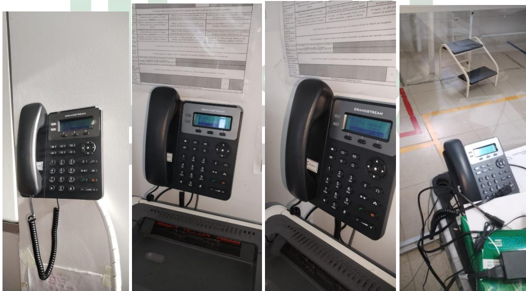
Teléfonos instalados en las áreas determinadas
