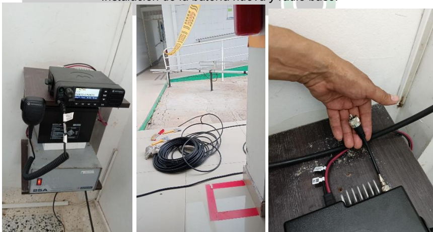
Cable RG8, conectores y radio base instalado con su respectiva batería.
