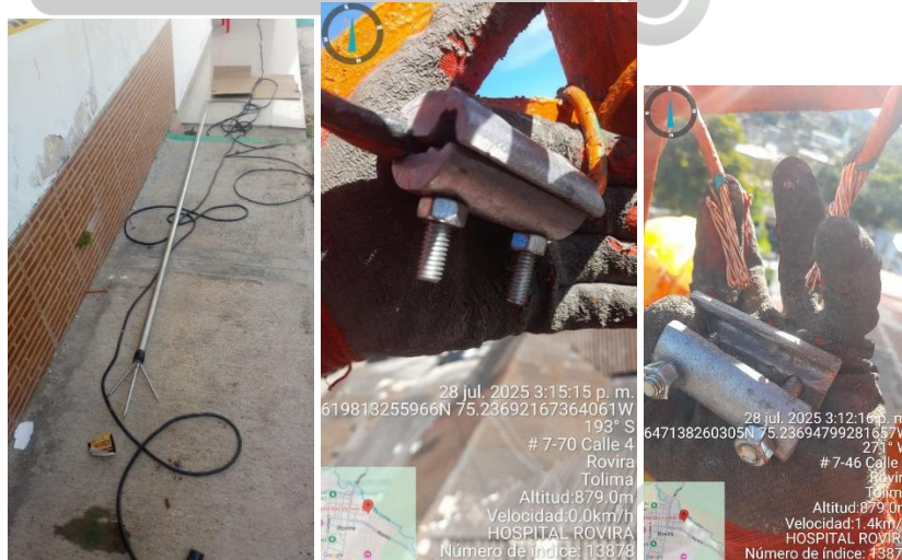
Acondicionamiento del pararrayos
