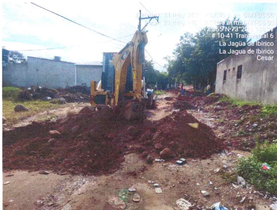
Imagen 2. Fallo presentado en un tramo.
