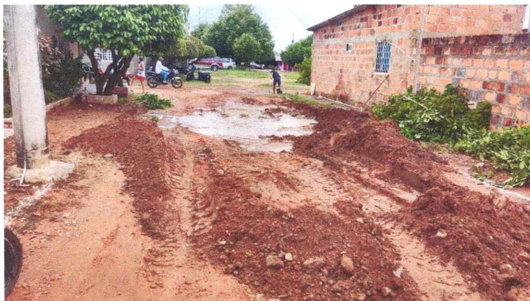
Imagen 1. Fallo presentado en un tramo.
