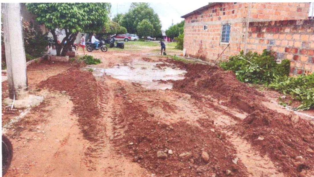
Imagen 1. Fallo presentado en un tramo.
