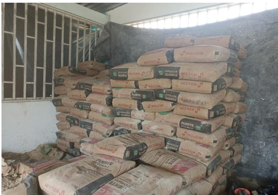
Imagen No 8. Almacenamiento temporal materiales de construcción (cemento)
