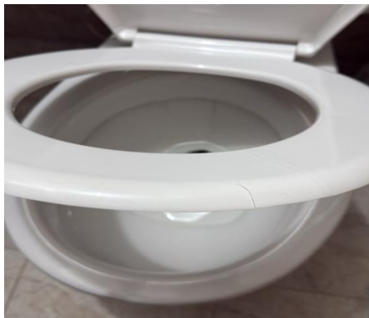
Se observa asientos rotos
