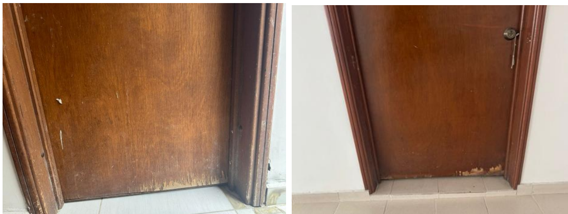
Se observa puertas en mal estado
