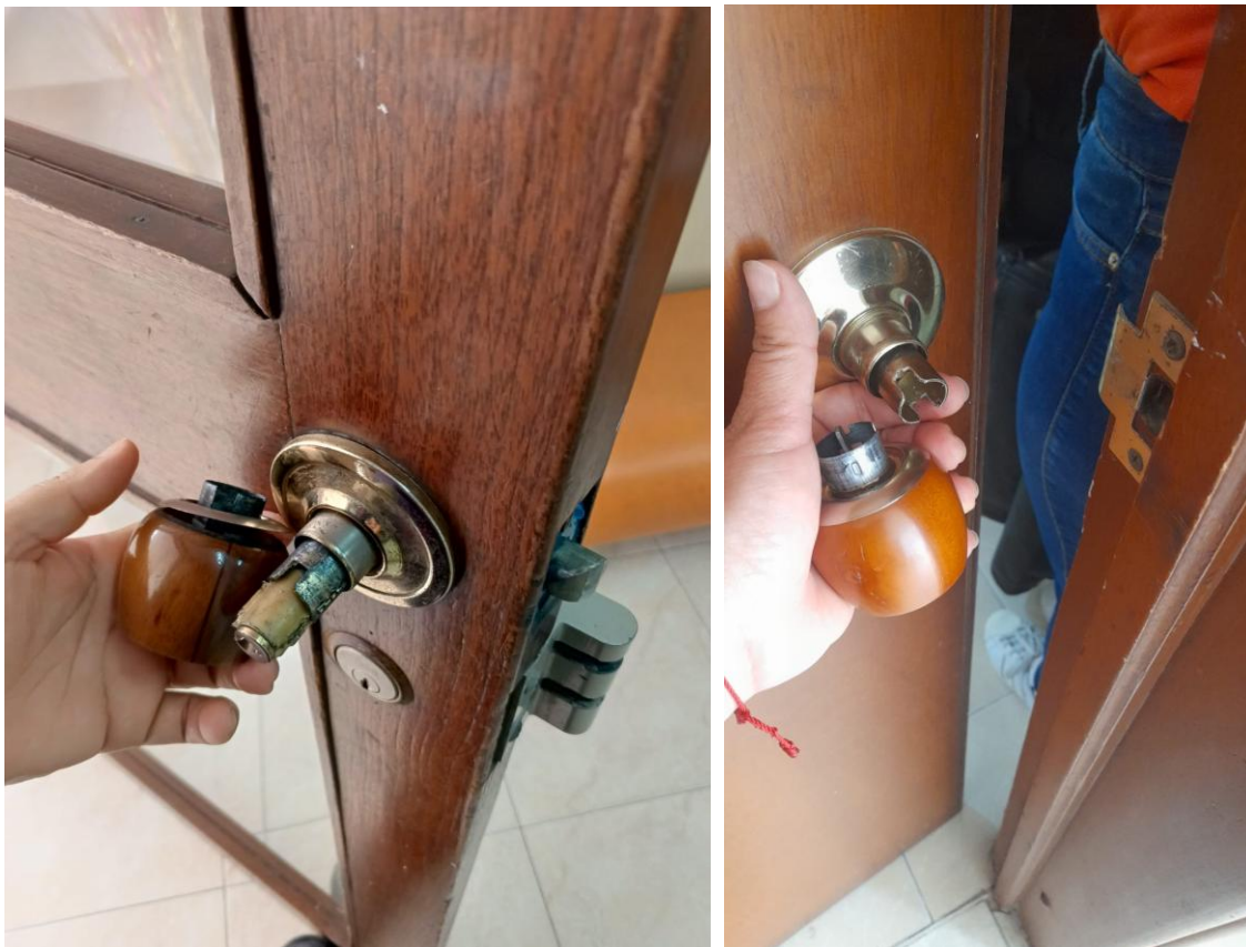
Se observan chapas en mal estado
