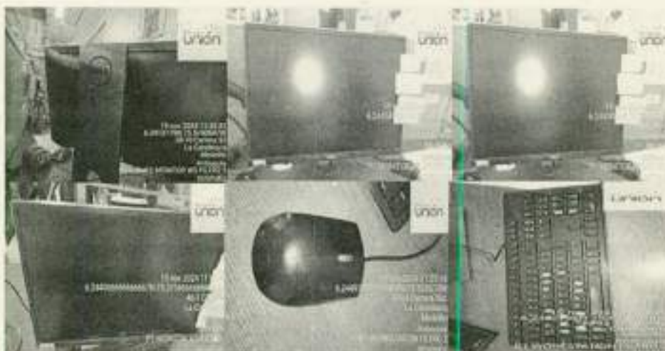
VISITAS DIAGNOSTICAS SISTEMA DE CONTROL ACCESO CAD
