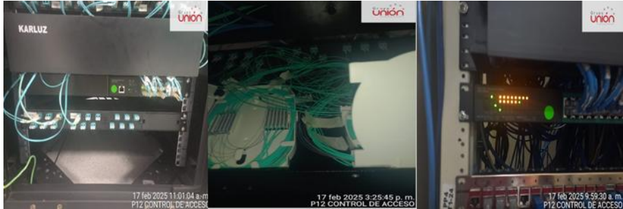
CONTROL DE ACCESO PISO 12
