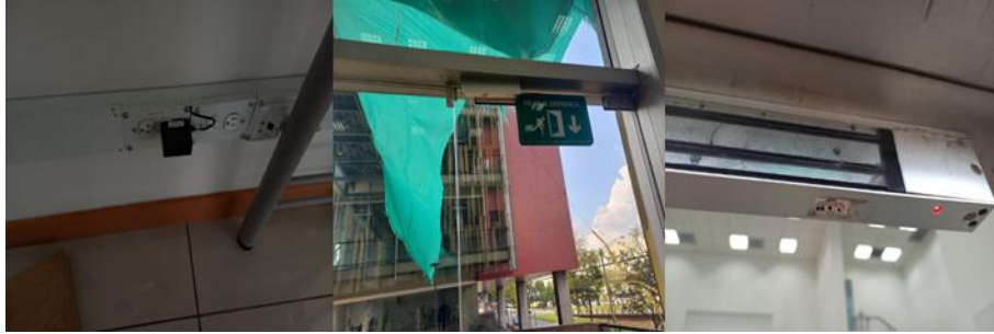
CONTROL DE ACCESO PISO 12
