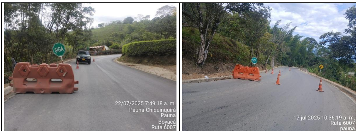
Registro fotográfico N.º 49 y 50: Ubicación de controladores de tráfico frentes de obra 6007
