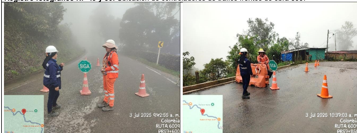
Registro fotográfico N.º 51 y 52: Ubicación de controladores de tráfico frentes de obra 6009.
