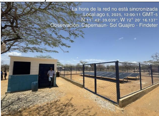
Fotografía 6. Sistema de potabilización de agua por medio de osmosis inversas en la comunidad de Capernaum.
