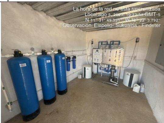
Fotografía 3. Componentes del sistema en buenas condiciones, insumos químicos en la comunidad de Sarrutpien.
