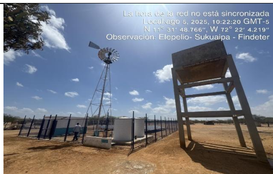
Fotografía 2. Sistema de potabilización de agua por medio de osmosis inversas en la comunidad de Sarrutpien.
