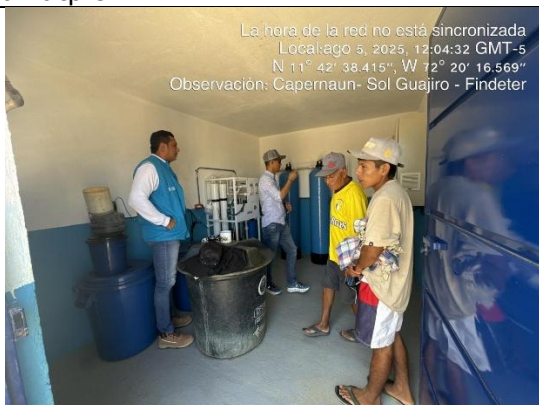
Fotografía 5. Revisión del sistema de potabilización en la comunidad de Capernaum.
