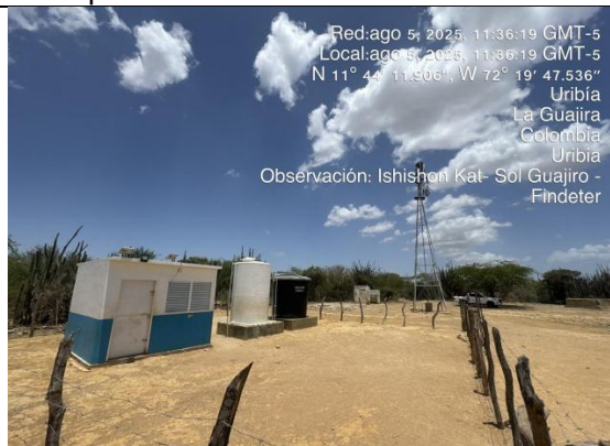
Fotografía 4. Sistema de potabilización de agua por medio de osmosis inversas en la comunidad de Ishishon Kay.
