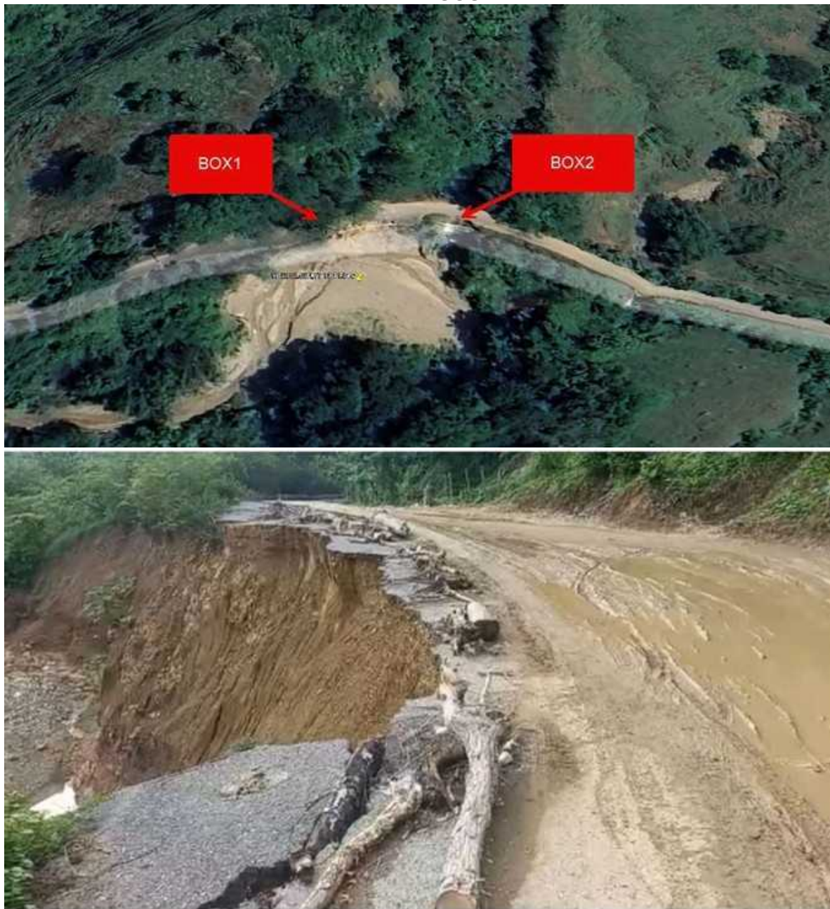
FIGURA 2. ESTADO DE LADERA DE BOXCOULVERTS SOBRE VIA SANTA CRUZ-CIEN PESOS
