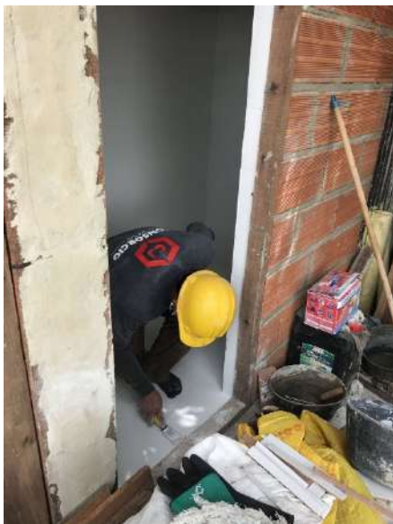
Fotografía No. 3. Lechada de piso unidad sanitaria N°3.
