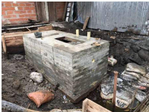
Fotografía No. 23. Tanque primario de aguas residuales.
