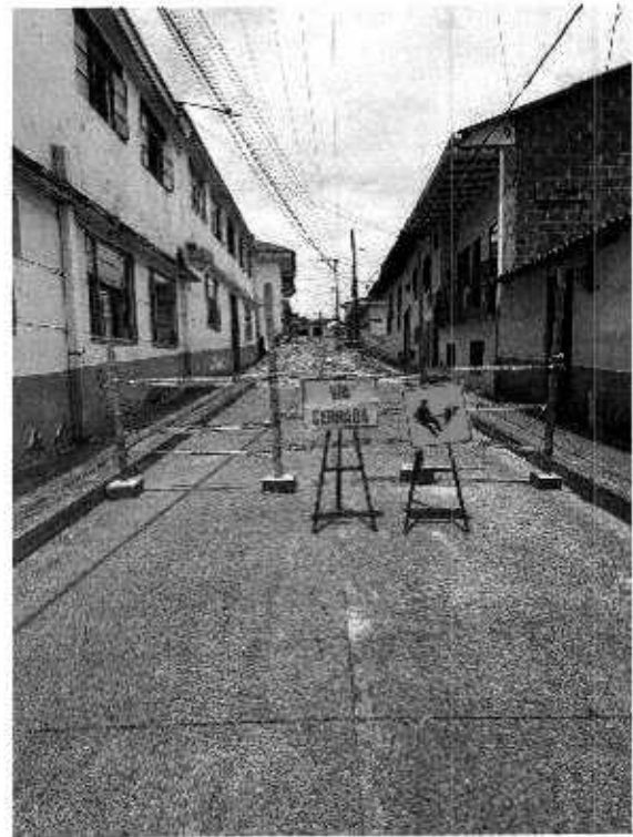
Foto N° 42: Señalización sobre Cra 4
