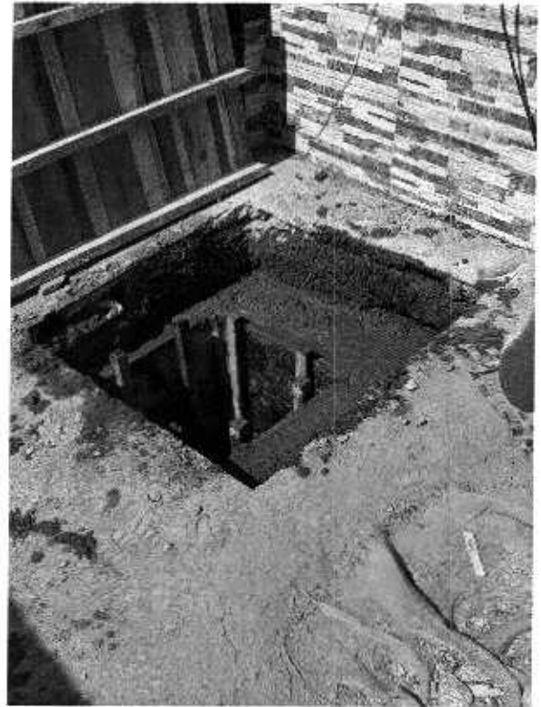
Foto N° 24: Caja de inspección de 50"50
