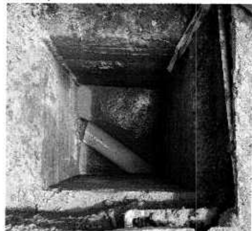
Foto N° 26: Cañuela con tubo de 6"
