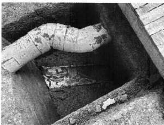
Foto N° 25: Cañuela con tubo de 6"
