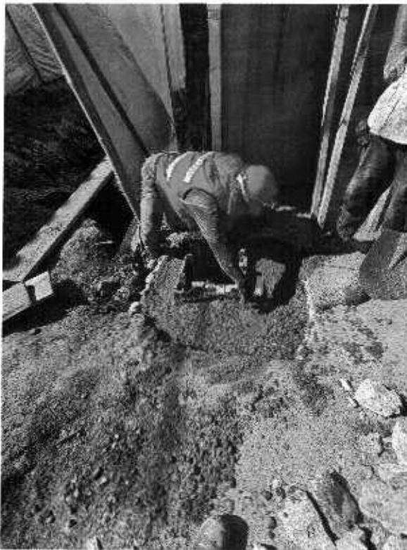
Foto N° 23: Caja de inspección de 50"50
