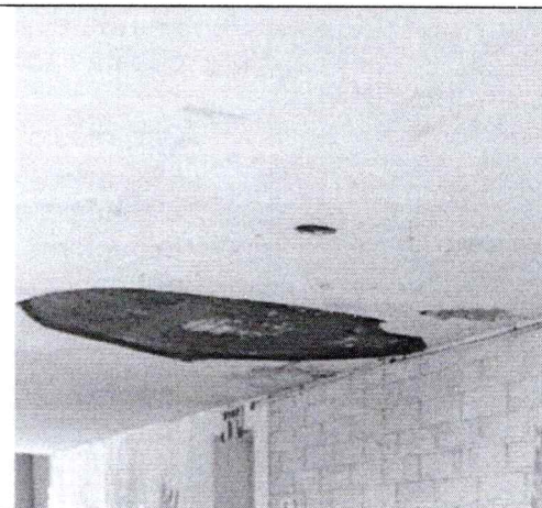
Fotografía 2 Se evidencia que la placa presenta acumulación de aguas lluvias.
