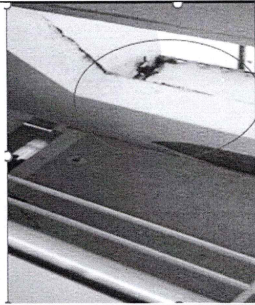
Fotografía 4 Deterioro en el pañete por las humedades constantes
