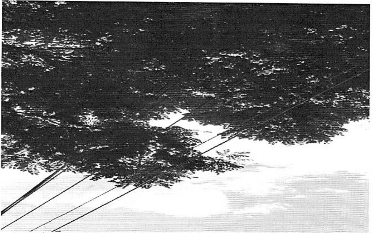
Redes Eléctricas Callejón del Higuero (Carrera 4 desde la calle 16 hasta la Orilla del Rio Cauca).
