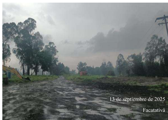
Descripción: Estado de las vías en Chocontá y Facatativá producto de las lluvias
