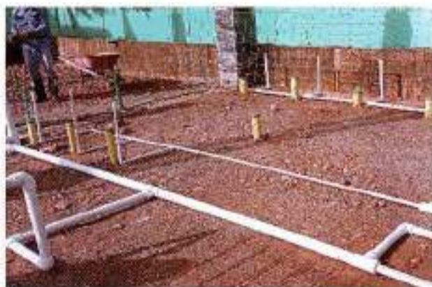
Foto 39: Tubería de presión en PVC
