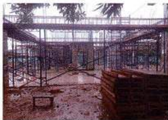
Foto 5: Presencia de lluvias en el sector
