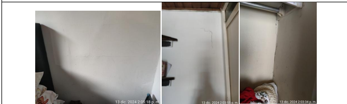
Foto 9, 10 y 11: Visita verificación fisuras PQRS No 5.
