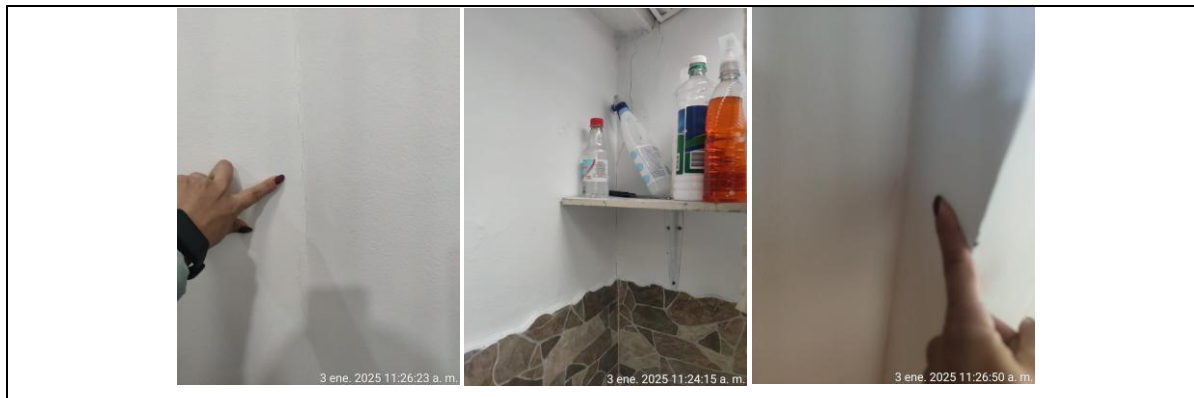
Foto 12, 13 y 14: Visita verificación fisuras PQRS No 6.
