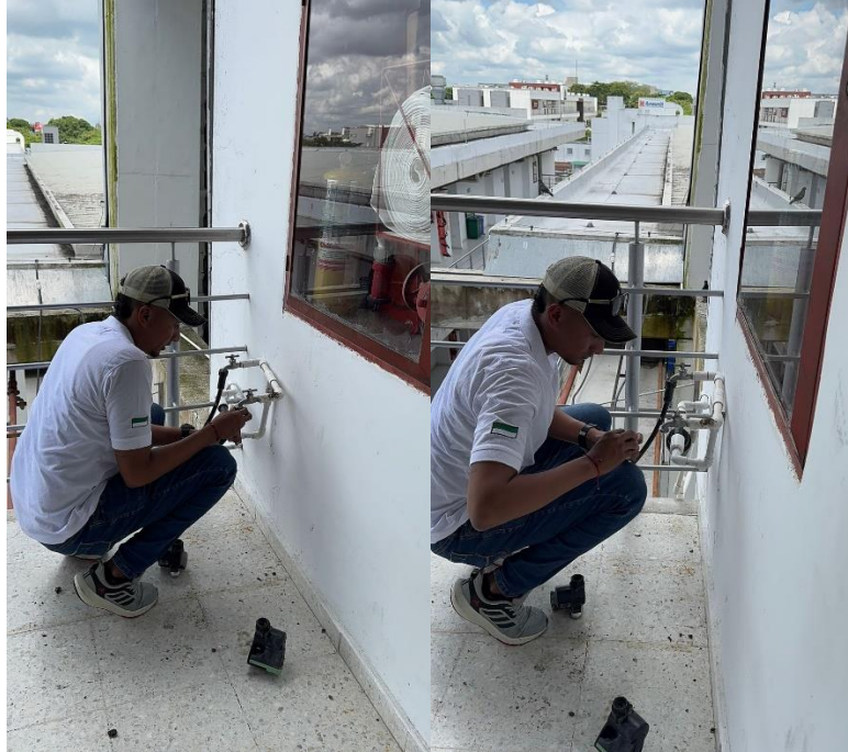
Foto. Calibración, cambio de batería, controladores del sistema de Riesgo
