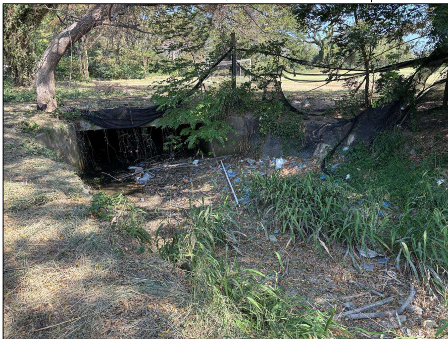
Ilustración 4. Estado de Box en Quebrada Bureche. Fuente Propia.
