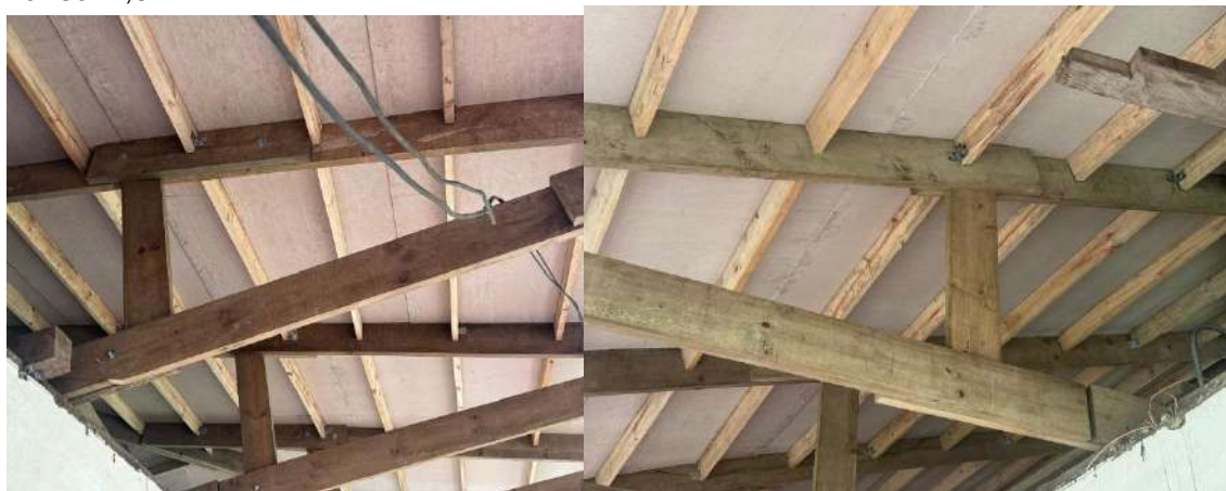
N.P.12 tacos metalicos soporte de la estructura de la edificación
