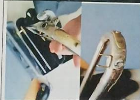
Llave de desagüe en mal estado
