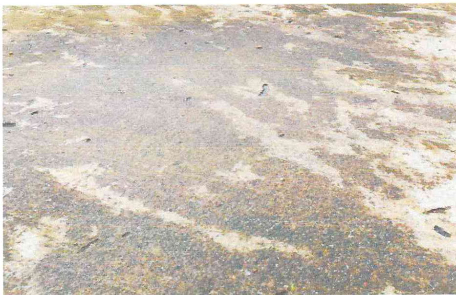
Losa con lesiones sobre la superficie
