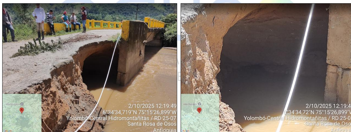
Imagen 2. Registro fotográfico afectación en el suelo de apoyo del puente de la Ahitona Fuente: Reporte oficial de afectaciones de la Dirección Operativa de Riesgos
