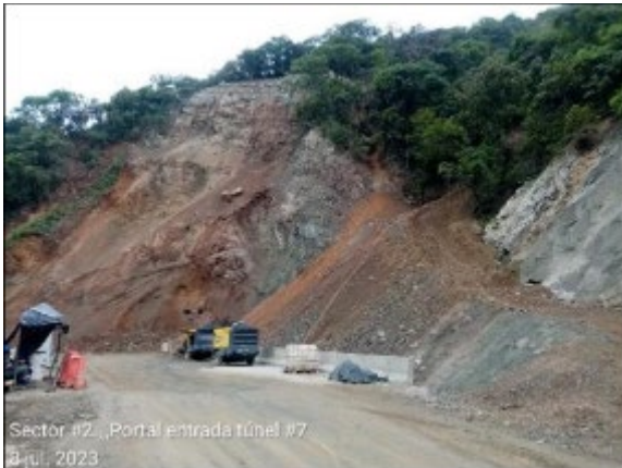
Foto 3-5 K13+730.84, estado inicial
