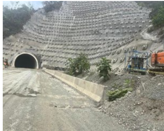
Foto 3-6 K13+730.84, estado actual
