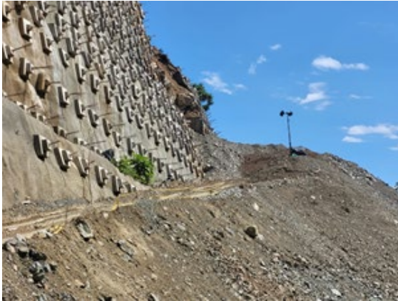
Foto 3-19 Túnel falso 2, Se presenta desprendimiento de material en la primera berma del talud (de abajo hacia arriba)
