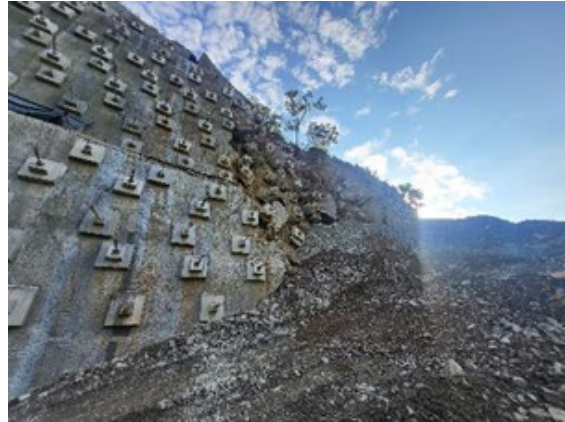
Foto 3-20 Túnel falso 2, Se reportó falla parcial en un área del talud el día 06/09/24
