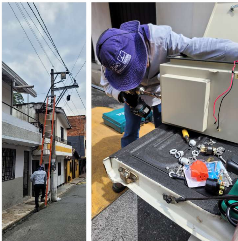
Figura 14.1: Instalación sirena SATC 19 de abril, Itagüí - 08 de abril de 2025.
