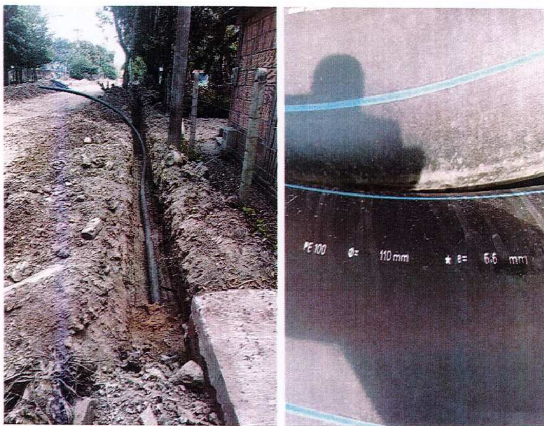
IMAGEN 34. TUBERÍA DE POLIETILENO PE 100 PN-10 DE \varnothing=110 MM =4".
