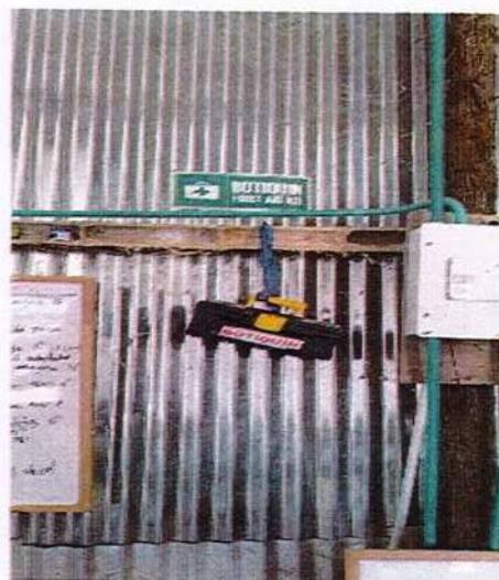
Fotografías 6.15. Botiquín que se encuentra debidamente identificado y a la vista.
