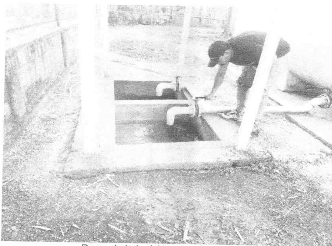
Purga de lodo del tanque de aireación.
