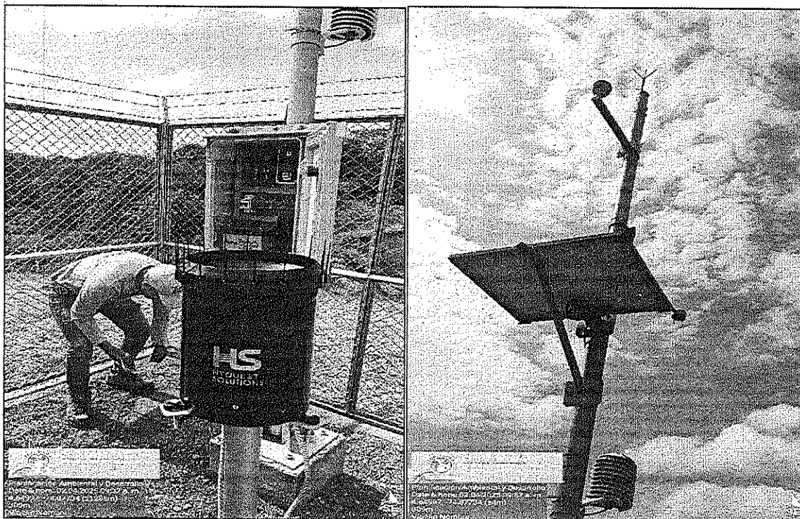
Fotografía No 5. Imagen general de la estación Meteorológica La Sonora, encerramiento, mástil, panel solar, sensores, gabinete y caja de polo a tierra.
