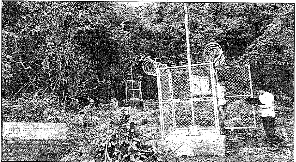
Fotografía No 10. Imagen general de la estación Hidrométrica Palmar, encerramiento, mástil, panel solar, sensores, gabinete y caja de polo a tierra.
