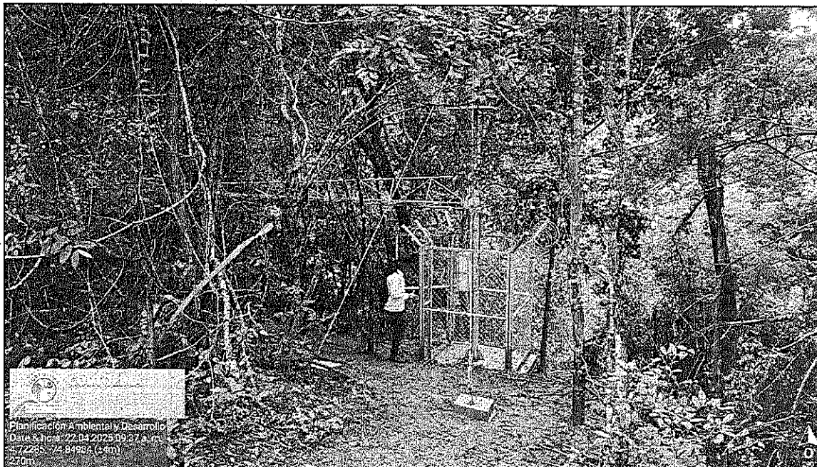
Fotografía No 13. Imagen general de la estación Hidrométrica Venadillo Bajo, encerramiento, mástil, panel solar, sensores, gabinete y caja de polo a tierra.
