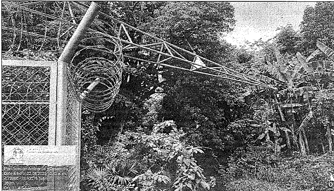
Fotografía No 17. Imagen general de la estación Hidrométrica Galapo, encerramiento, mástil, panel solar, sensores, gabinete y caja de polo a tierra.
