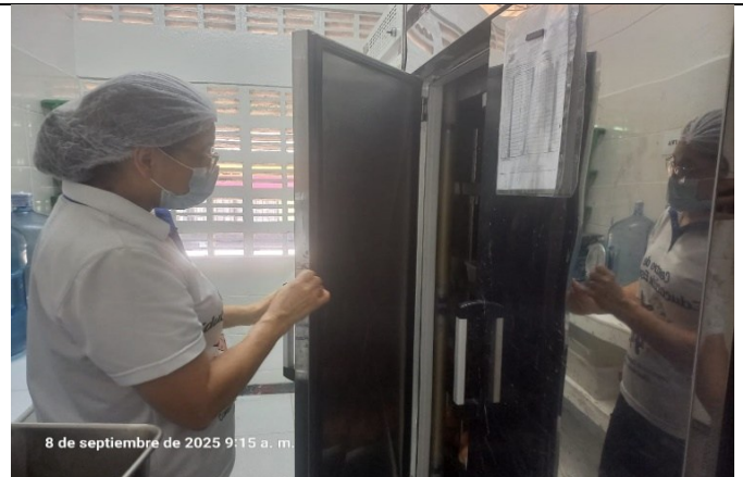
Inspeccion de equipos de refrigeracion
