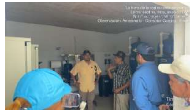
Fotografía 3. Seguimiento al sistema de potabilización de agua en la comunidad de Amasirralu.
