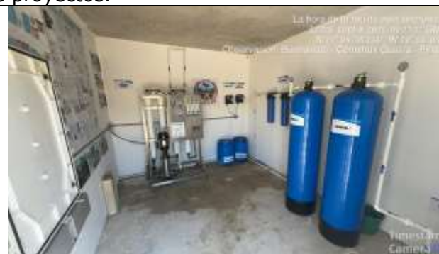
Fotografía 2. Sistema de potabilización de agua en la comunidad de Buenavista.
