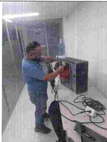
Mantenimiento de Servidor tipo torre
