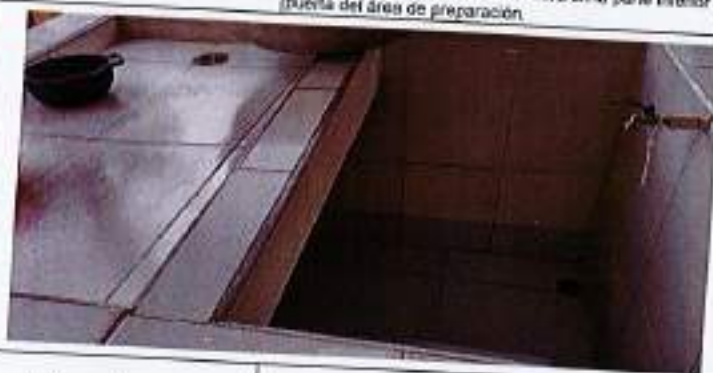
Fotografía No. 04 Abastecimiento de agua
