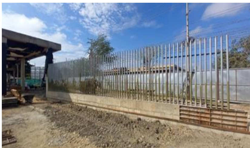
Ilustración 66. Módulos de tubería de cerramiento externo
