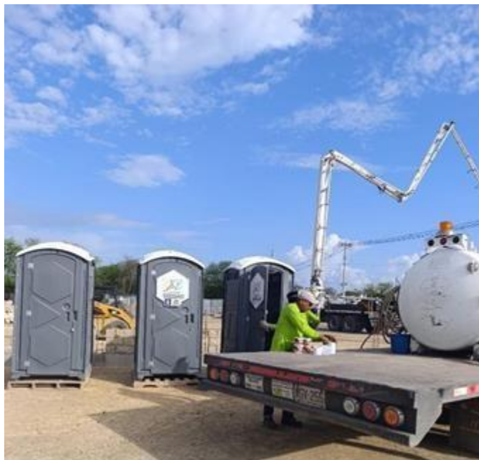
Ilustración 83. Mantenimiento de baños portátiles ecológicos.
