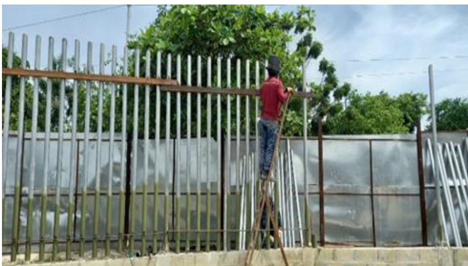
Ilustración 60. Módulos de tubería de cerramiento externo paralelo al canal perimetral
